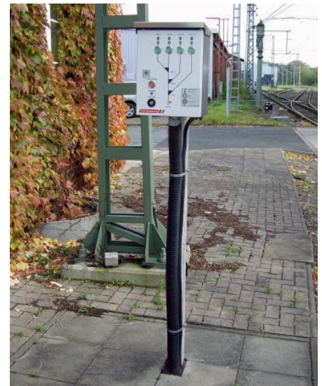
Abb. 4: Fahrwegstelltafel für EOW-Fahrwegsteuerung
