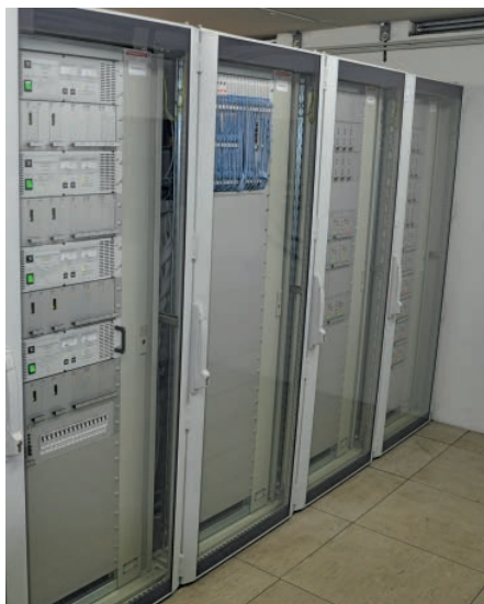
Abb. 6: Innenanlage eines Rangierstellwerks vom Typ TMC-RaStw
