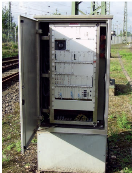
Abb. 3: EOW-Steuerung im Außenschaltschrank
